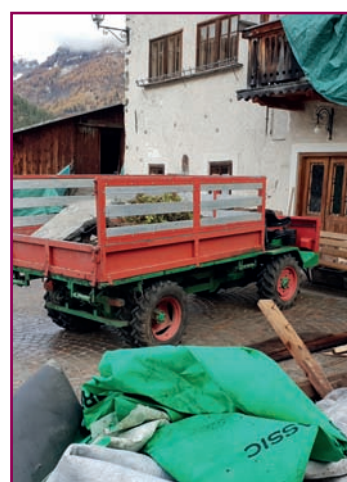
Tutti al lavoro nel centro storico per ripulire le strade dalle lamiere e dai travi.
