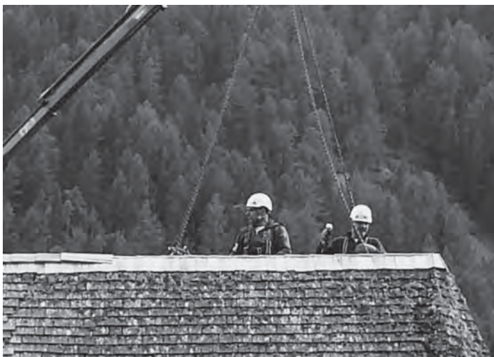
Gli operai della ditta Gasser Schindeln di Barbiano (BZ) riparano il colmo della chiesa di S. Giovanni danneggiato dalla neve.
