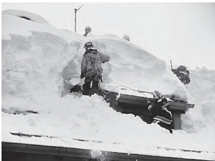
I Vigili del Fuoco intervengono per mettere in sicurezza il tetto del Municipio.
